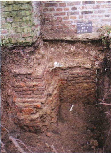
Abb. 9: Bergheim. Stadtmauer. Fundament mit mehreren Ausbesserungen. Foto: Fa. Goldschmidt Archäologie & Denkmalpflege, Düren.
